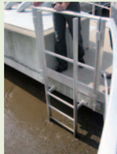
Portillon de protection avec échelle
