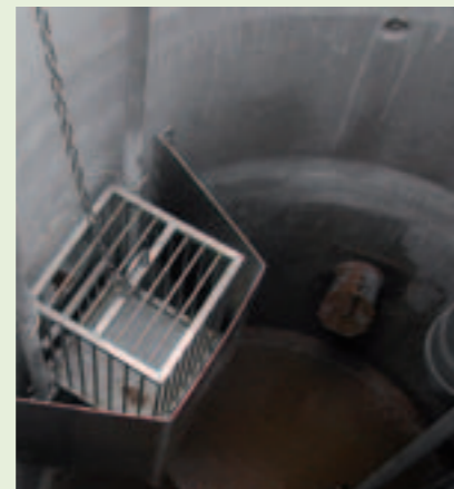
Panier de dégrillage
