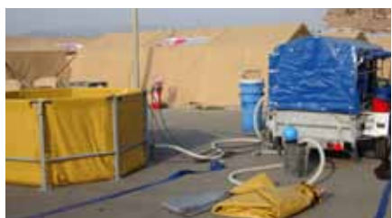
> Bassin de décantation CLARIF
