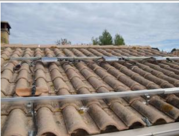
6 m 2 sur toiture avec 3 micro-onduleurs ancrage pour 3 modules crédit photo GPPEP
