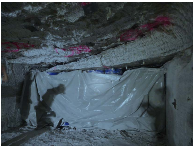
Figure 3 : Désordres miniers sur le bloc 21. Source : Présentation par K-UTECH AG Salt Technologies
