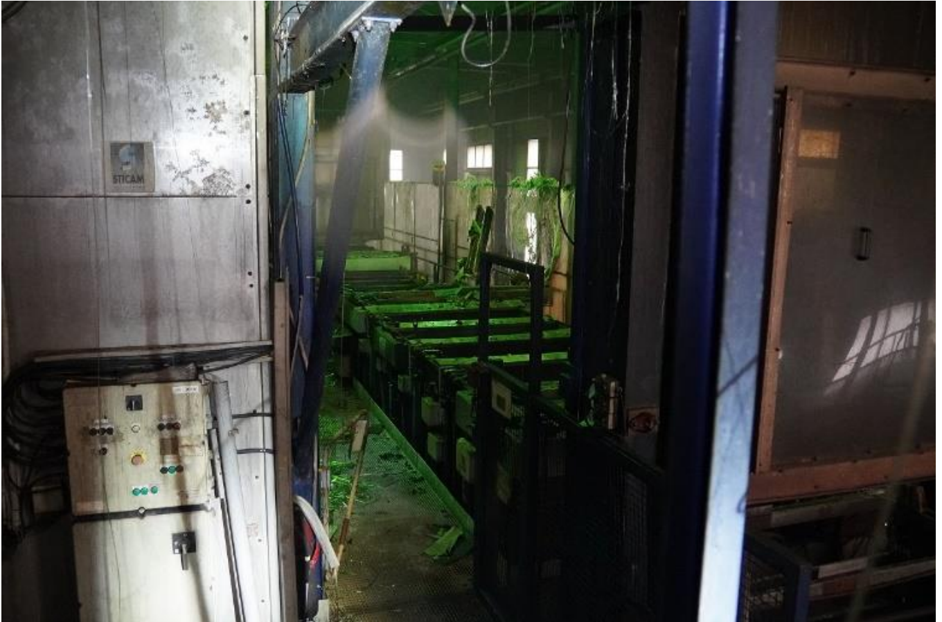
Figure n°6 : vue générale de l'atelier
