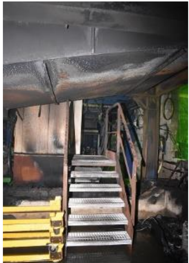
Figure n°4 : cheminement de la gaine d'aspiration en PE détruite
