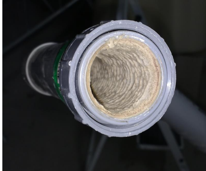
Figure 5 : Incrustation dans un PVC \varnothing 50 mm avec une pente de 4 % en deux ans de fonctionnement
