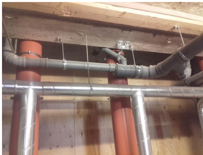
Figure 6 : Réseau de collecte d'urine (PVC), de chute des matières fécales (rouge) et de ventilation des cuves de collecte des matières fécales (argenté).
