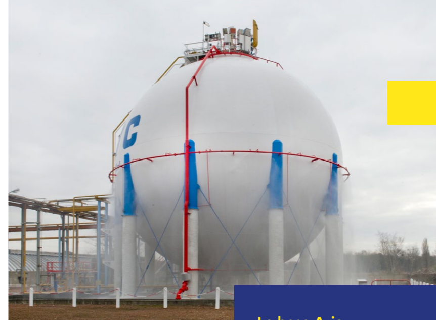
Laurent Mignaux / Terra Usine de production de PVC : arrosage de la sphère de stockage après dépotage en cas d'incendie
