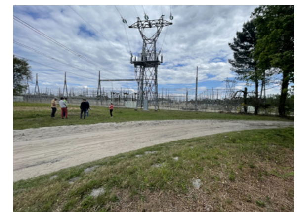
Cubnezais, poste électrique actuel
