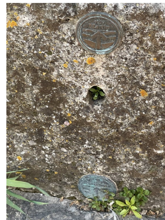
Saujon, repère de crues de deux tempêtes
