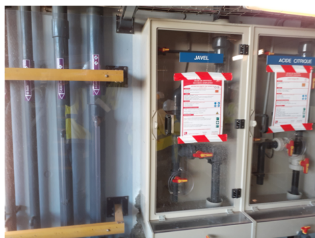
Tuyauteries de produits chimiques sur le site d'Achères - Février 2023 | Crédit : DRIEAT Île-de-France
