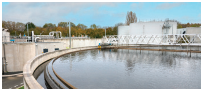
Station d'épuration de Bourge Plus (18)
